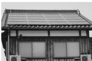
設置された市内産太陽光発電パネル
