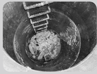
▲油のかたまりなどで詰まってしまった下水マンホールの中
