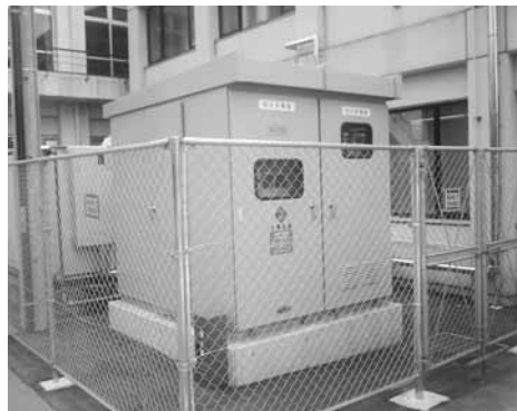
各施設にある受変電設備
