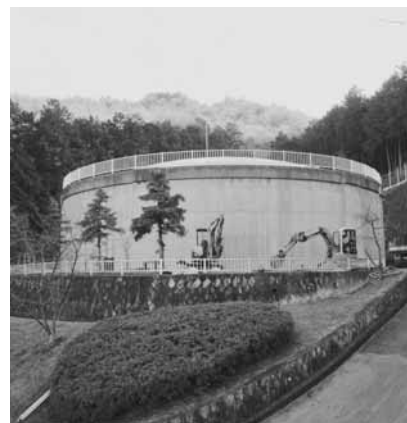
市民の飲料水を支える上水道配水池
