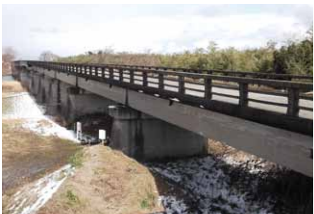
亀裂の見つかった栗見橋
