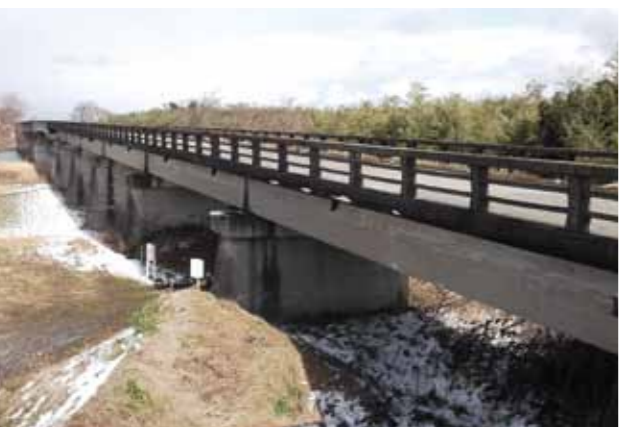
亀裂の見つかった栗見橋
