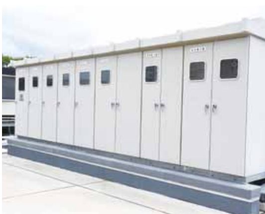
市役所の高圧受電設備
