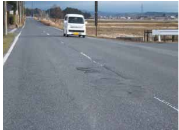
センターラインが消え損傷が目立つ市道
