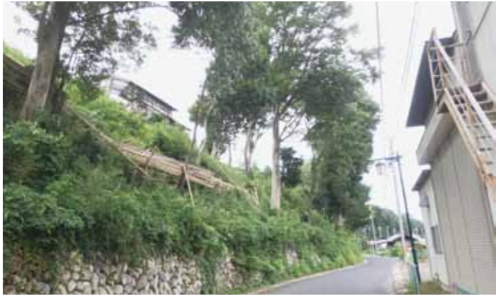
対策が待たれる急傾斜地
