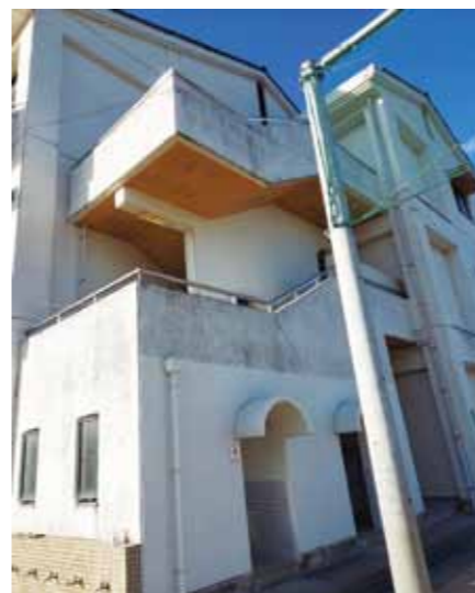
改修が急がれる学童保育所
